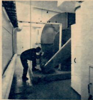
En av varmluftsfläktarna i ventilationrummet. Hela uppvärmningen är termostatreglerad. Fläktvåningens är inrymd direkt under taket.
