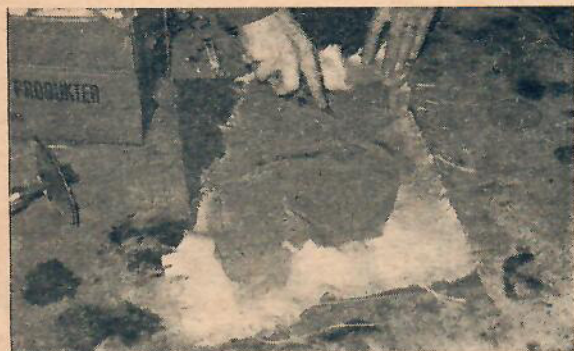
Vid stora skador som på den här flygeln är det bäst att armera med fiberglas. Glasväven klipps till och bestrys med plast på den sidan som skall ligga mot plåten.
