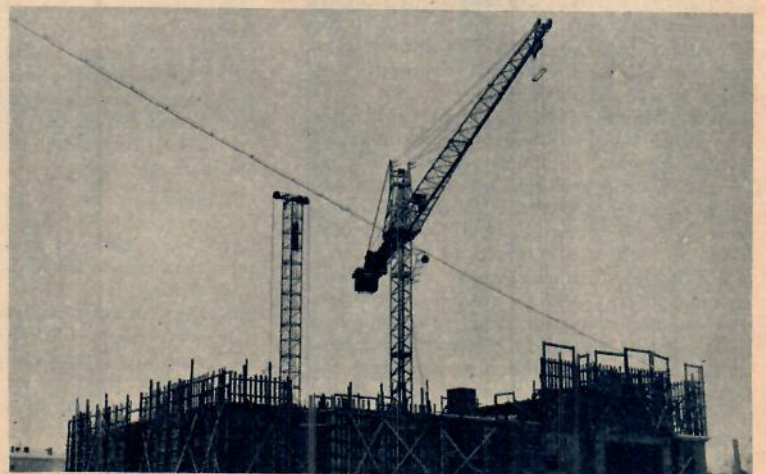
Ett nytt hus har påbörjats i Nybodaområdet i Solna. Kranen följer med hela vägen upp i tvåvåningarskliv. När bygget är klart firas den ned längs utsidan.
