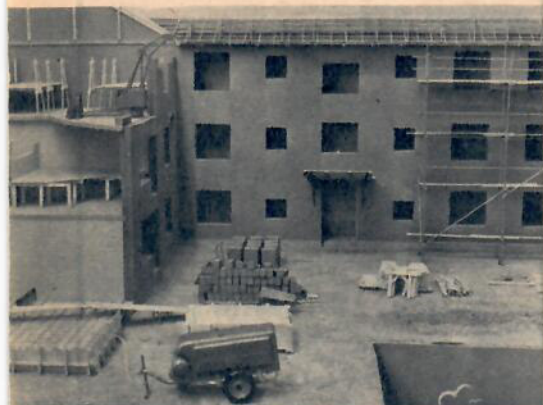
Så här snyggt skall det se ut på en byggnadsplats om olyckan skall hållas borta. Skyddsstatet, rejäla ställningar, ordning, reda, är medlen.
