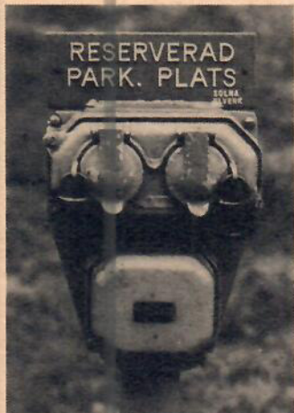
Sådana här reserverade parkeringsplatser med möjlighet att ansluta elvärmare syns alltmer nuförtiden.
