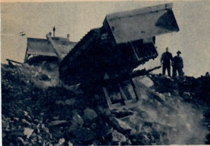
En bandtraktor med schaktblad har tappat fästet för sina larvfötter och börjar sin rullning utför stenhögen med en halsbrytande baklängesvolt.
