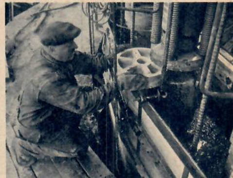
När man lyft 10 cm är det dags för uppallning. En i taget höjs domkrafterna och lättmetallskivor sätts in.
