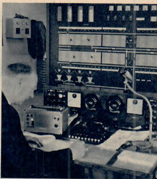
Från ett centralt kontrollrum kan arbetet på hela anläggningen överblickas. Elektriska signallampor på panelen i bakgrunden talar om vilka maskiner som går.
