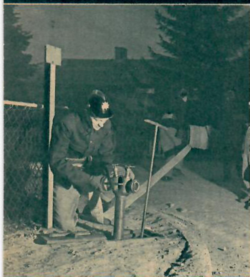
En slangutläggningsgrupp: Fyran, Bengt Johansson har till uppgift att snabbt anbringa brandposthuvudet och slangen.
