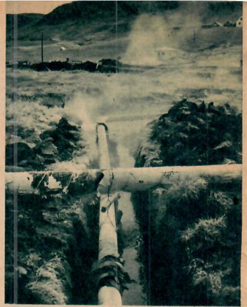
Från Reikir, 16 km från Reykjavik, leds varmvattnet i isolerade stålror till staden. Varma ångor stiger upp från källvattnet.
