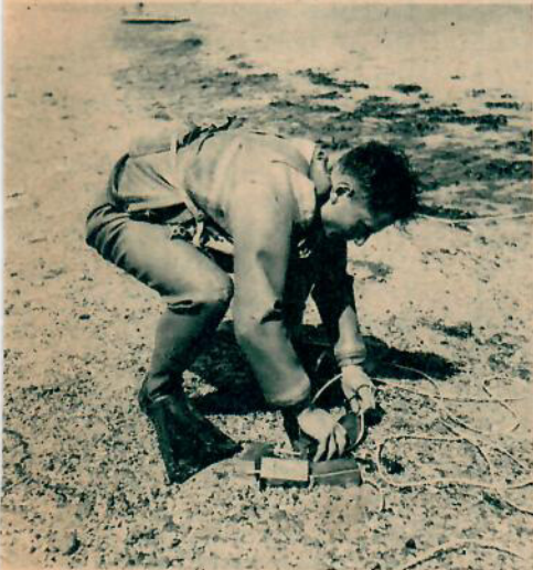
En kraftig sprängladdning placeras snabbt på en på förhand bestämd plats och...
